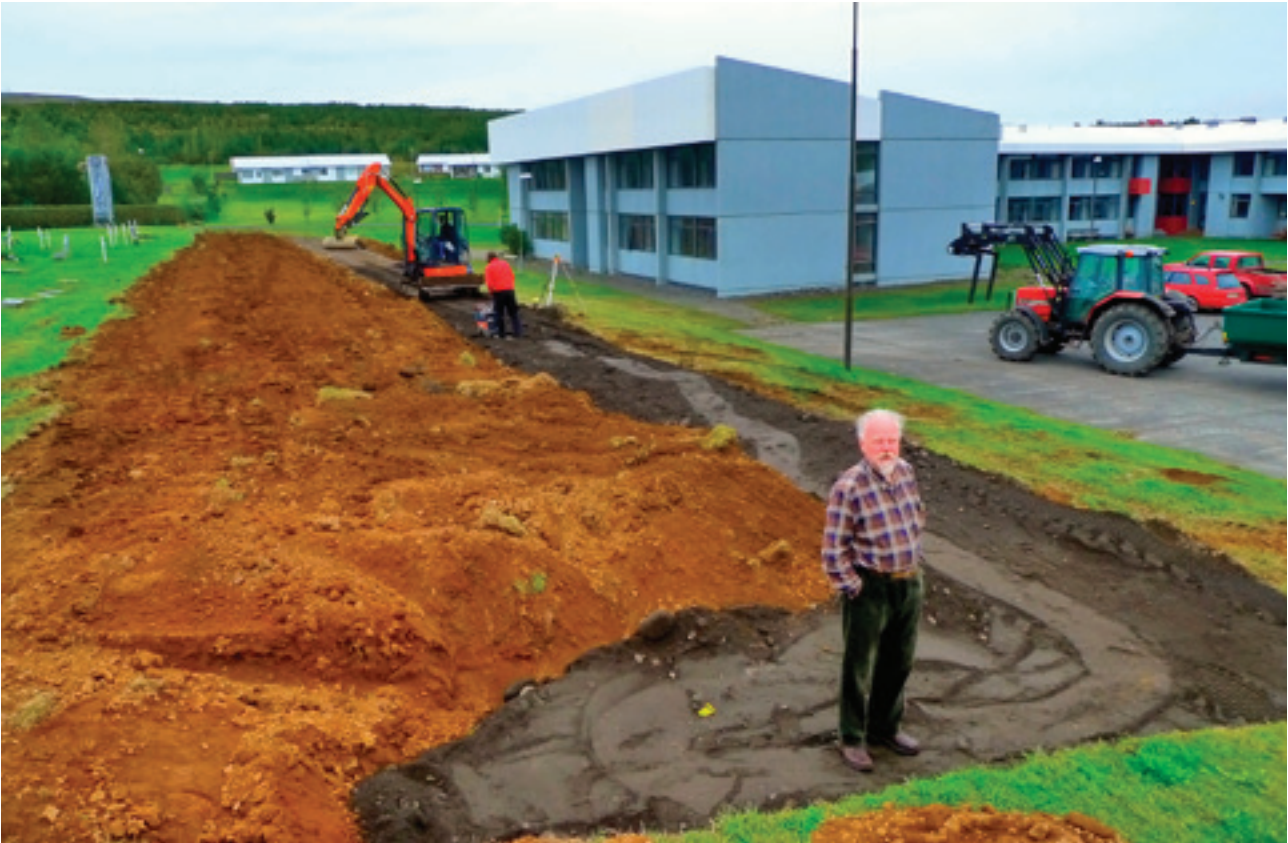
Framkvæmdir við austurmörk garðsins stóðu yfir í þrjú sumur. Í forgrunni er séra Geir að stýra sínum mönnum!
